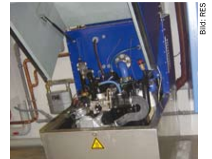
Energieeffizienz und Klimaschutz: Ein 13-kW-BHKW von EC Power versorgt mit Strom und Wärme zwei Wohngebäude in Göppingen
