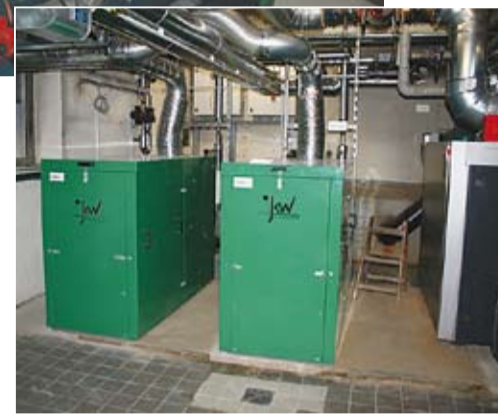
Die veraltete Heizanlage wurde durch ein Pflanzenöl-BHKW in Kombination mit einem Heizöl-Spitzenlastkessel ersetzt
