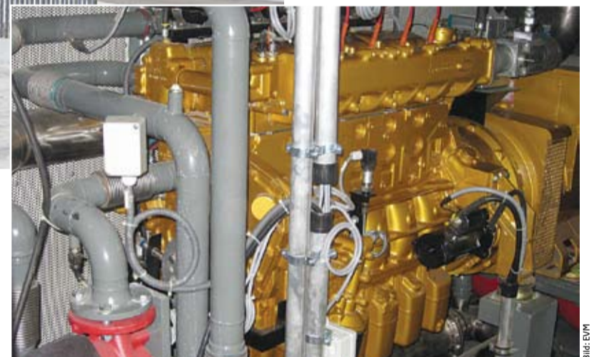
Sorgt für Energieeffizienz, Umweltschutz und Wirtschaftlichkeit: ein Flüssiggas-BHKW
