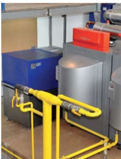
Auf Sommerbedarf ausgelegt: BHKW-Module der EC Power
