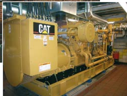
Heißgekühltes Gasmotor-BHKW-Modul ersetzt im Martin-Luther-Krankenhaus vier Dieselmotor-Aggregate
