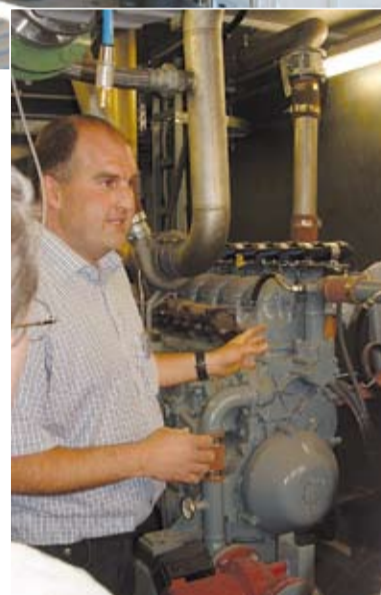
Christian Eder: „Das Öl nimmt den Teer auf und wird dann als Brennstoff nach und nach in den Vergasungsprozess zurückgeführt“
