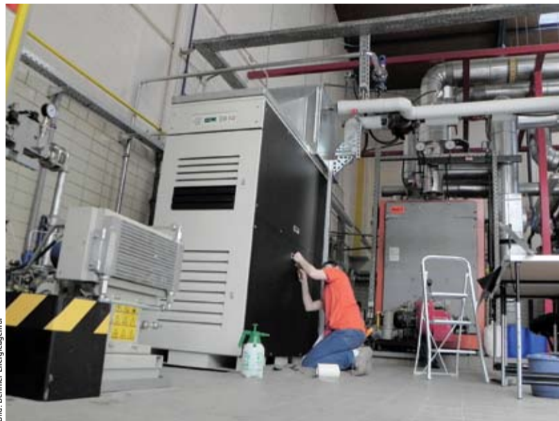
Von der Berliner Energieagentur für die BVG installiert: Mikrogasturbine C 50 von Capstone
