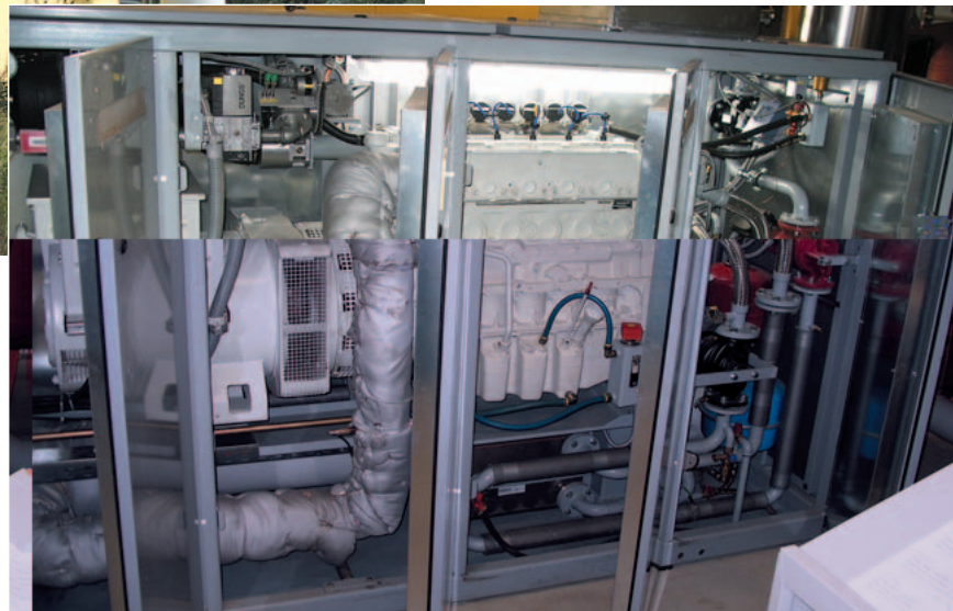
Die Energiezentrale in Glinde war bereits für den nachträglichen Einbau eines BHKW-Moduls vorbereitet
