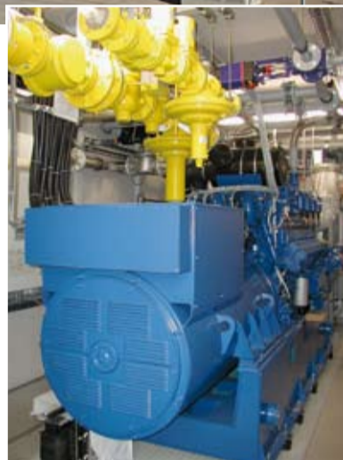
Ein 700-kW-BHKW erzeugt aus Biogas Strom und Wärme für Neuhoof
