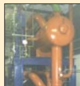
Dampfstrahlkältemaschine in Gera
