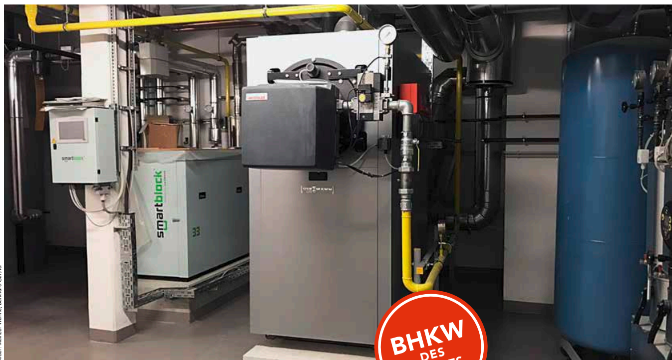
In der Energiezentrale sind unter anderem das BHKW sowie Kessel und Speicher untergebracht
