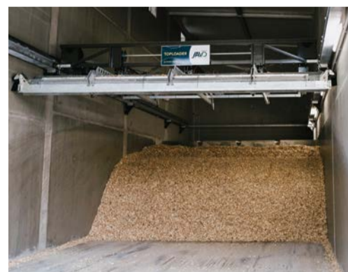
Das Brennstofflager befindet sich oberirdisch, die Kompaktierung findet im hinteren Bereich statt. Damit ist für die Anlieferung vorne immer ein freier Lagerplatz vorhanden
