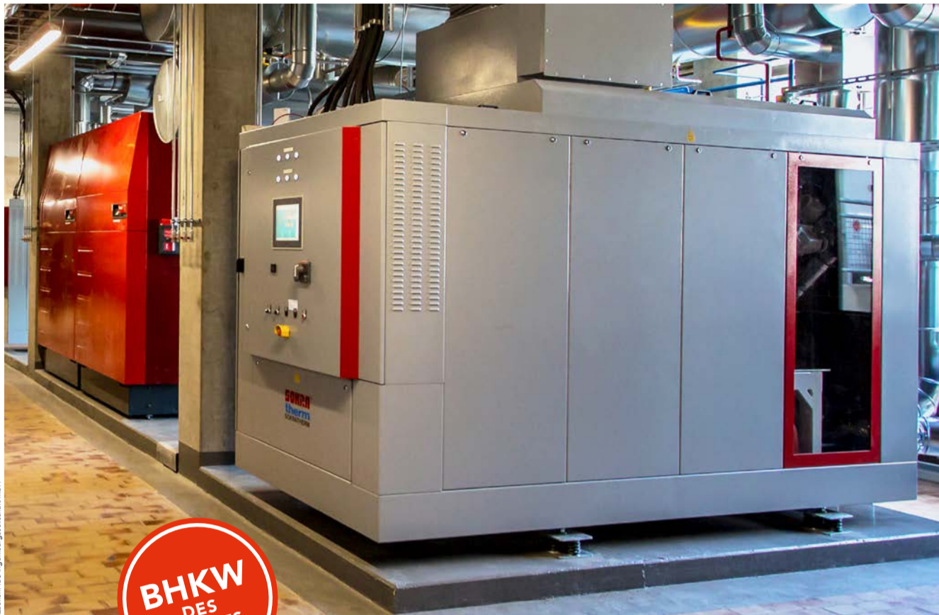
Die Energiezentrale mit den BHKW im Schul- und Verwaltungsquartier Ravensburg
