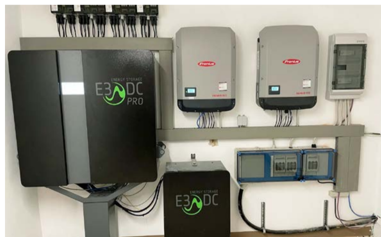
Ein Batteriespeicher garantiert in Kombination mit BHKW und Solar eine nahezu autarke Versorgung
