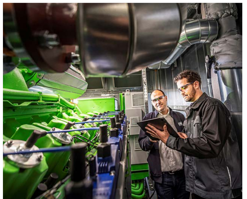
Heiko Strittmatter, Leiter Wärmeversorgung und Stromerzeugung bei den Stadtwerken Bad Säckingen (l.), und Moritz Kempf, Servicetechniker bei der Energas BHKW GmbH, im Heizkraftwerk
