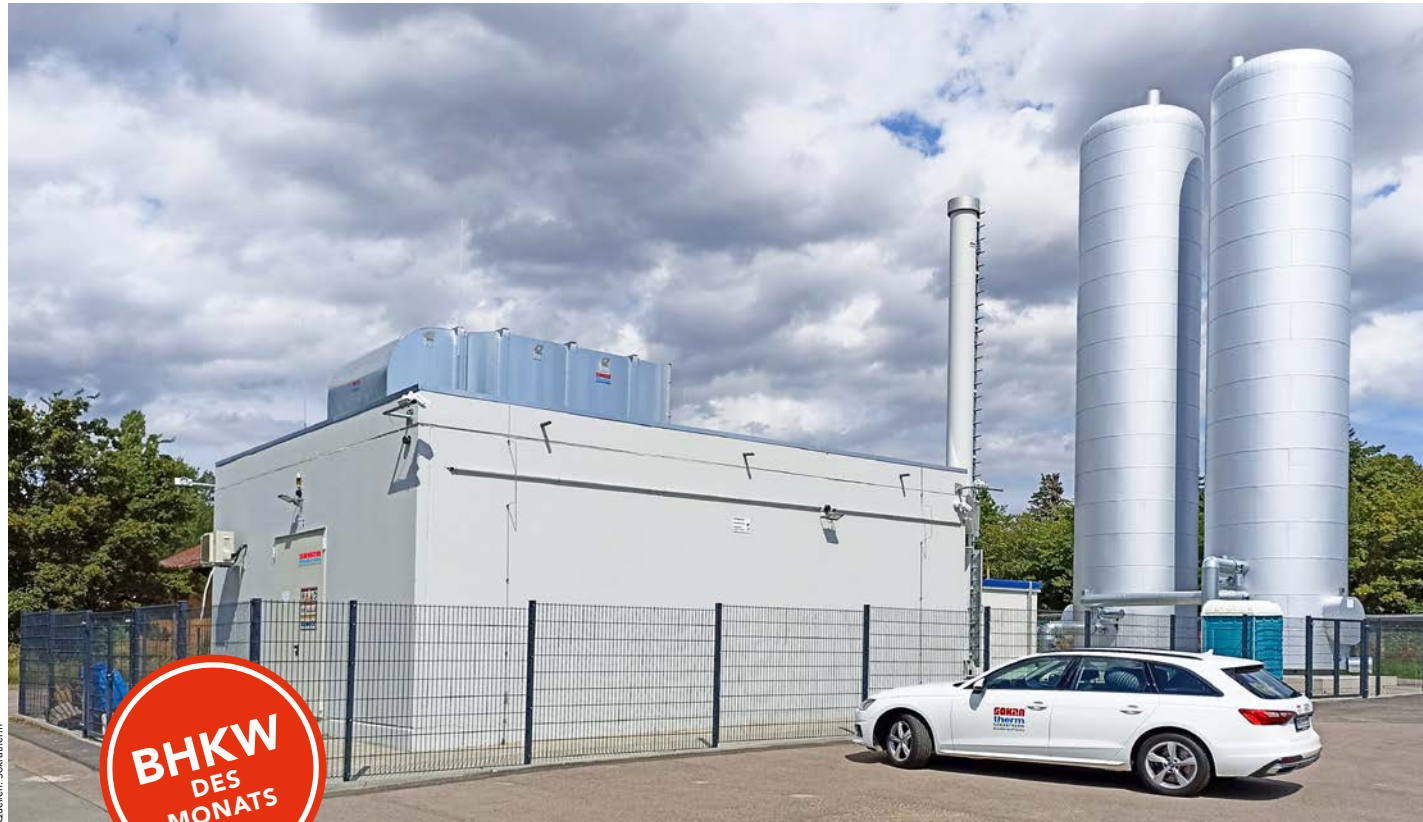
BHKW-Einhausung mit dem Wärmespeicher in Kitzscher
