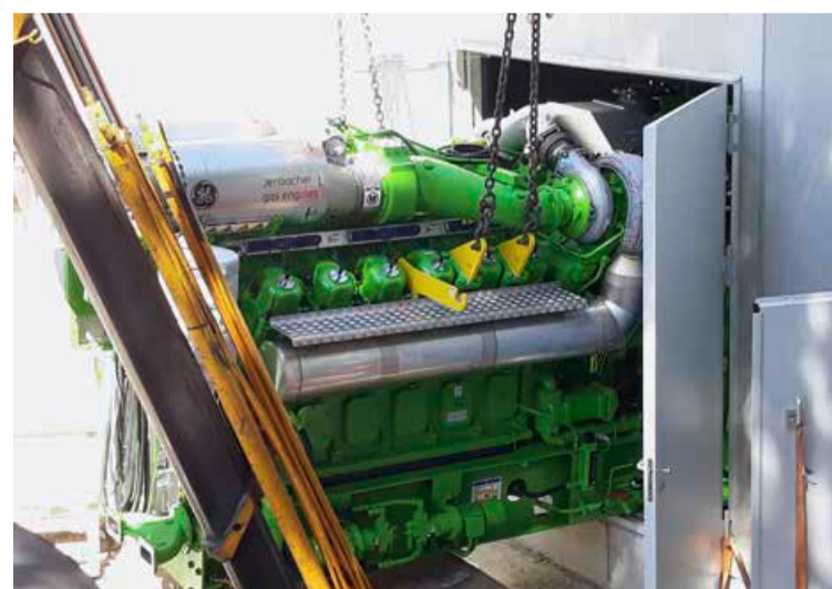
Damit die Gäste es immer warm haben: Die BHKW-Anlage läuft wärmegeführt nahezu rund um die Uhr
