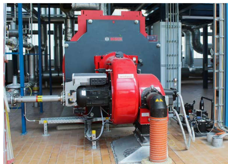
Die Kesselanlage am Flughafen Memmingen
