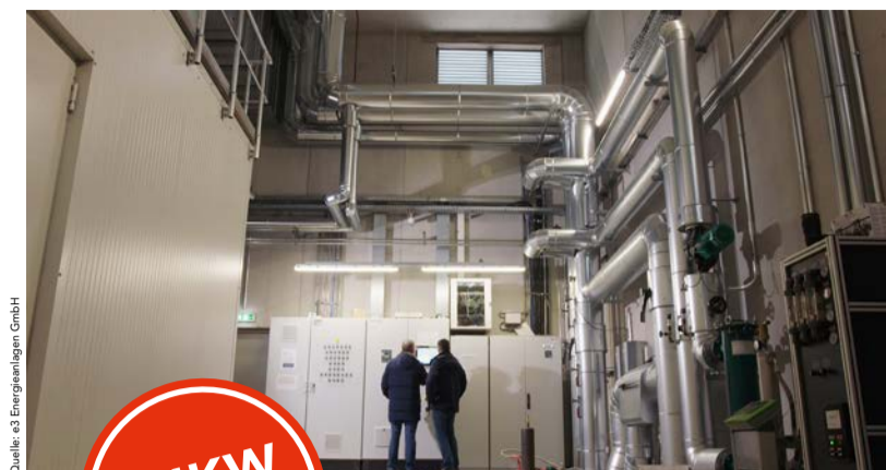
In Möglingen ist ein Jenbacher-BHKW installiert worden
