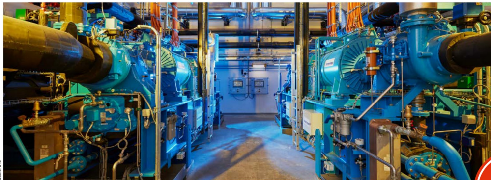
Auch zwei Flusswärmepumpen gehören zum iKWK-Projekt
