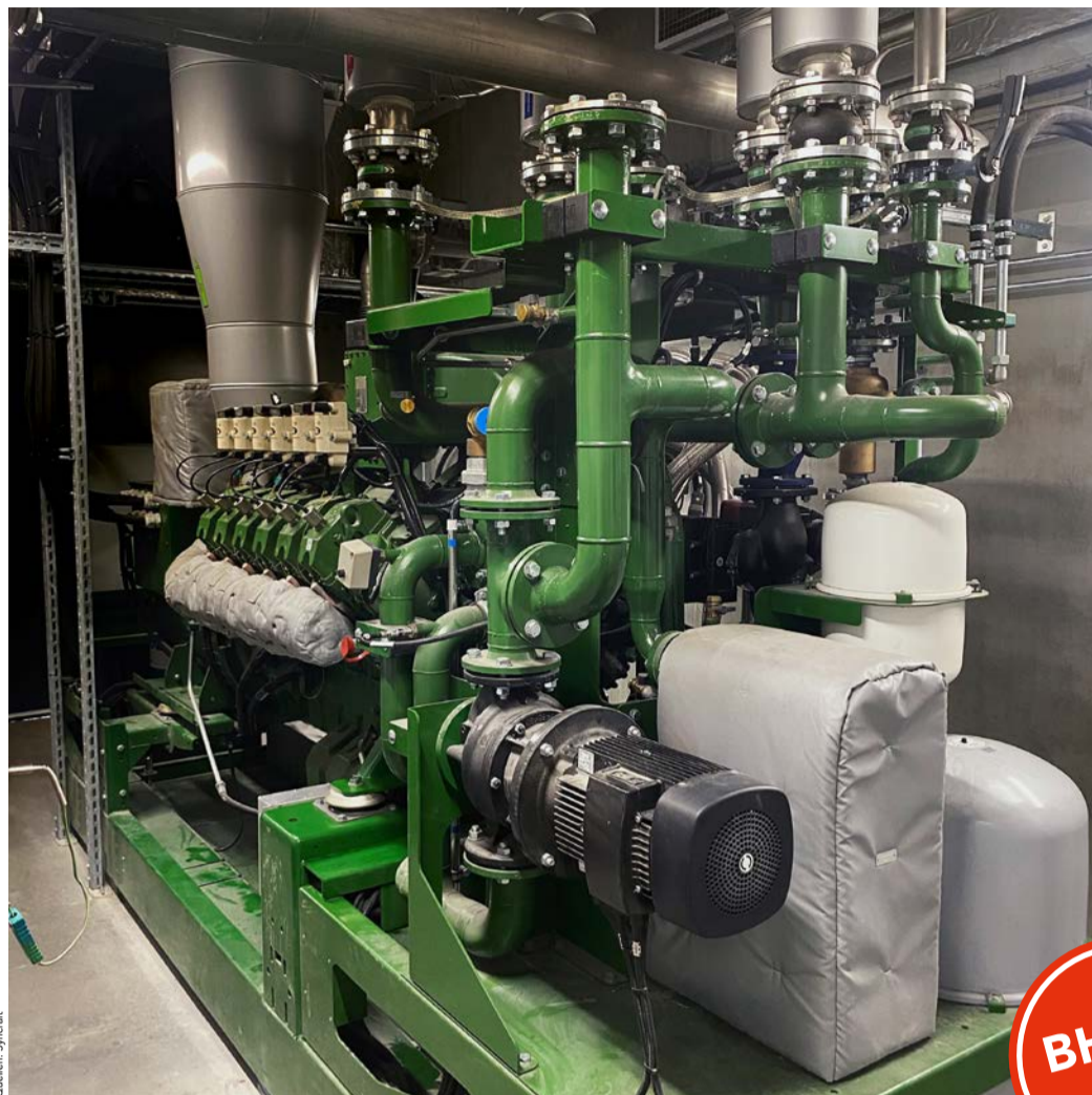
Das 2G-BHKW in Ternitz
