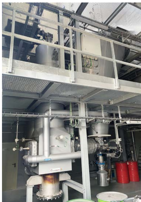
Die Anlage in Ternitz ist ein Holzkraftwerk, das Wärme, Strom und Pflanzenkohle produziert
