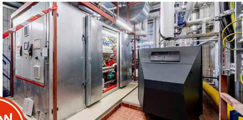
Ein BHKW-Modul von SES versorgt die Polizeiwache in Berlin
