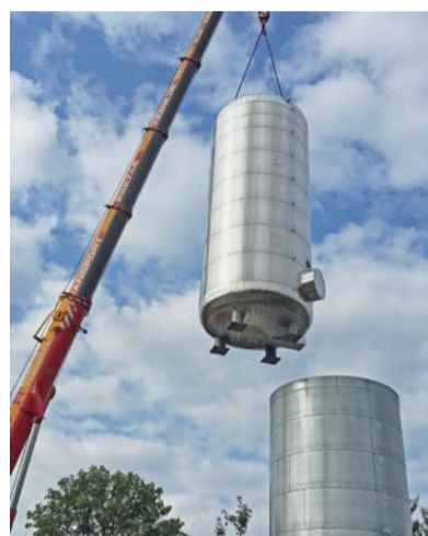
Der zweite Pufferspeicher wurde neben dem bestehenden installiert
