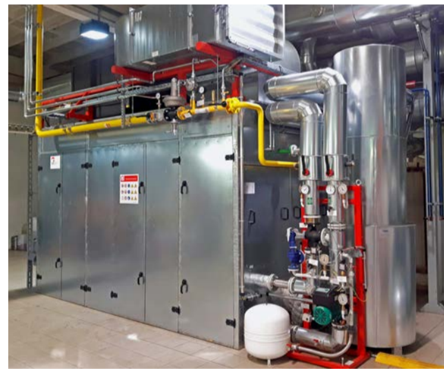
Das BHKW im Heizkraftwerk Gorndorf
