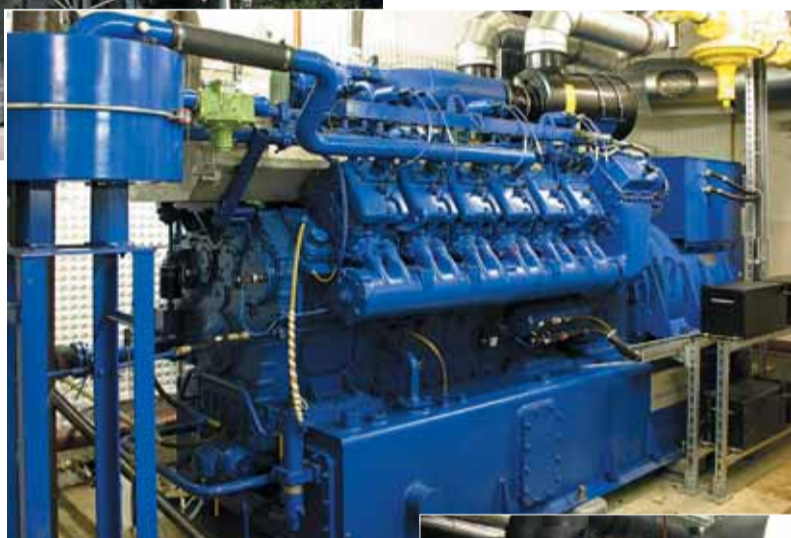
Auf knappstem Raum untergebracht: Erdgasgefeuertes BHKW-Modul von Deutz Power Systems und zweistufige Broad-Absorptionskälteanlage von GasKlima
