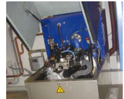
Energieeffizienz und Klimaschutz: Ein 13-kW-BHKW von EC Power versorgt mit Strom und Wärme zwei Wohngebäude in Göppingen
