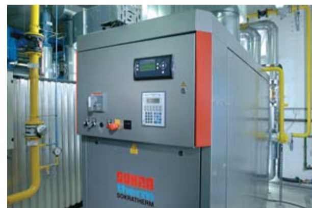
Für Flüsterbetrieb angepasst: 140-kW-BHKW in der Dachheizzentrale
