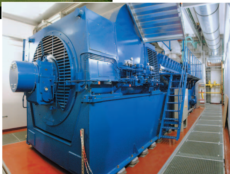
Grundlage für sichere und präzise Energieversorgung bei AMD in Dresden: neun BHKW-Module mit Deutz-Gasmotoren
