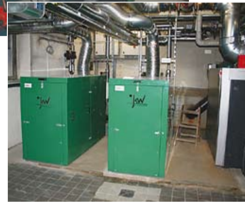
Die veraltete Heizanlage wurde durch ein Pflanzenöl-BHKW in Kombination mit einem Heizöl-Spitzenlastkessel ersetzt
