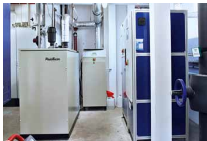
Hohe Auslastung durch die Kombination eines Powertherm-BHKW-Moduls von Spilling ...
