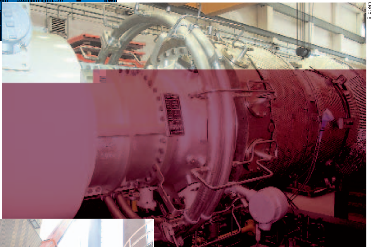
7,5 MW-Gasturbine in Kombination mit einem 40 t/h-Hochdruckdampfkessel: Fliegender Wechsel von Erdgas auf Erdöl und von Abhitze zum Frischluftbetrieb möglich
