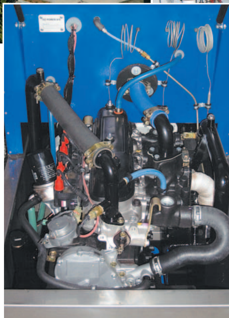
Parallel zum Brennwertkessel installiert: Das leistungsmodulierende 13-kW-BHKW der EC Power
