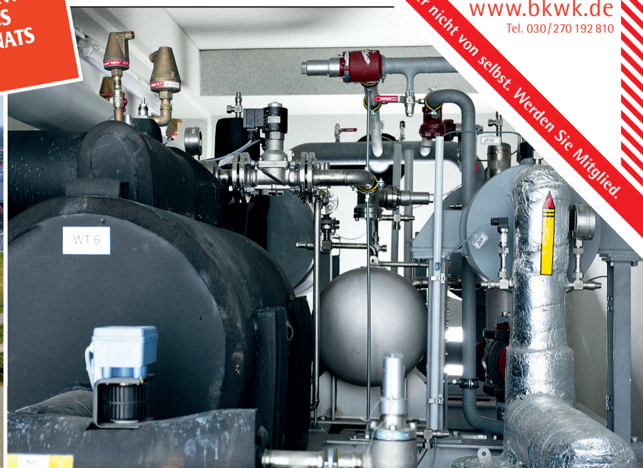
Eine Tieftemperatur-Absorptionskälteanlage nutzt im Sommer die BHKW-Abwärme
