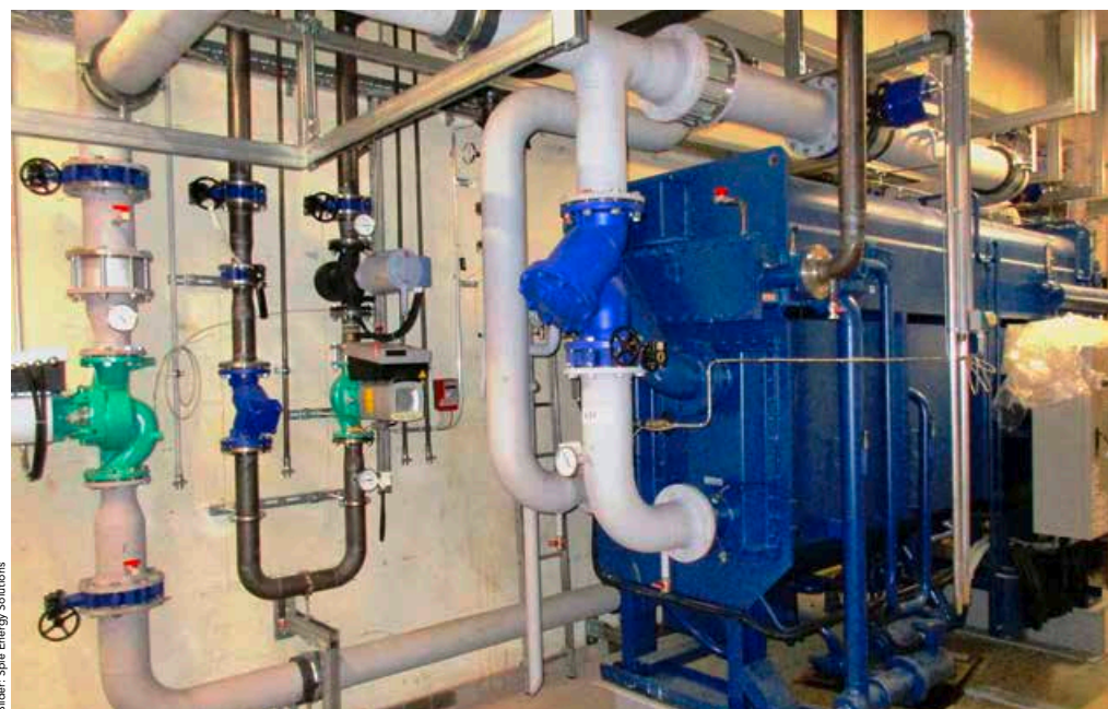
Die Absorptionskältemaschine am Klinikum nutzt die BHKW-Wärme im Sommer zur Kühlung
