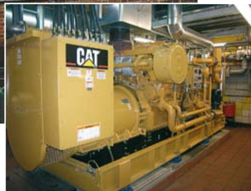
Heißgekühltes Gasmotor-BHKW-Modul ersetzt im Martin-Luther-Krankenhaus vier Dieselmotor-Aggregate
