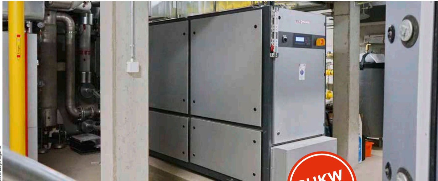
Das BHKW deckt mehr als 80 % des Wärmebedarfs der Siedlung
