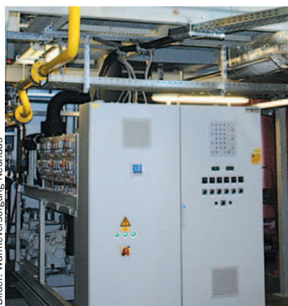
Nutzt BHKW-Strom zur Einbindung von Abwärme: Wärmepumpe von Combitherm
