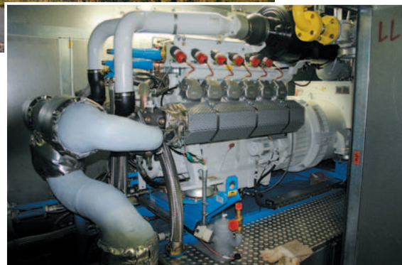
Liefert in Neuhaus am Rennweg Wärme sowie Strom für eine Wärmepumpe: ein BHKW von MDE
