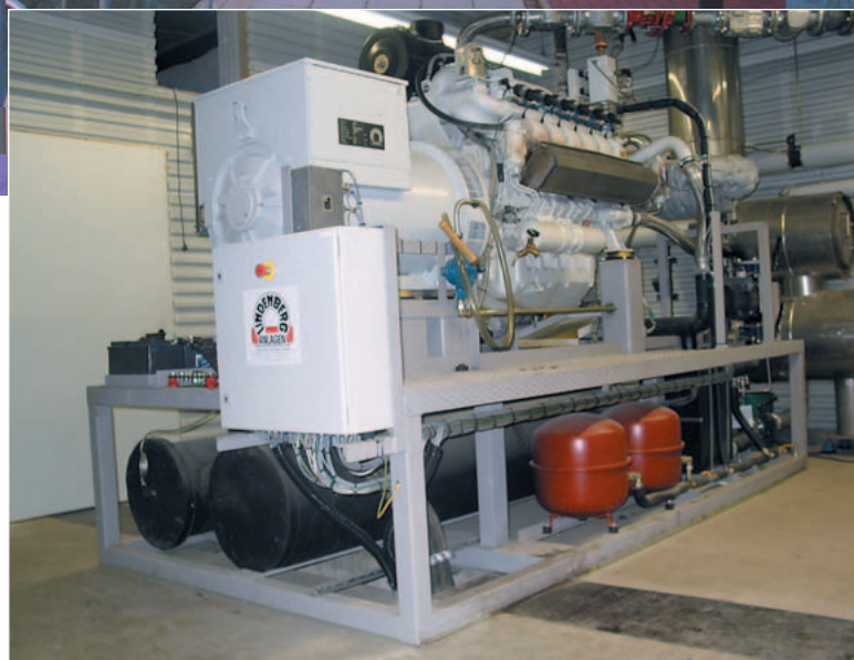
Biogas-Blockheizkraftwerk im Ortskern: Brummt durch Quarter-Lambda-Pipes herausgefiltert
