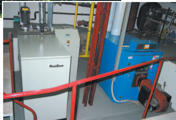
Unter optimalen Raumbedingungen eingebaut: BHKW-Modul Powertherm 20 der Spilling Energiesysteme in der Földiklinik in Hinterzarten im Schwarzwald
