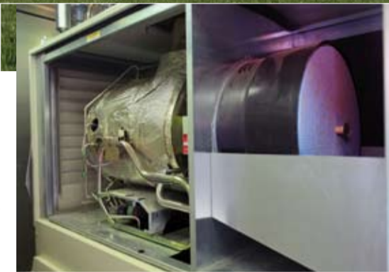
Das emissionsarme Abgas der Capstone-Turbine ist 300 °C heiß und wird – mit Luft verdünnt – mit etwa 50 °C in die Trocknungshalle geleitet
