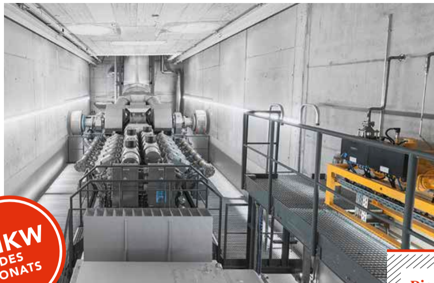
Ein neues MAN-BHKW steht seit Ende vergangenen Jahres im Heizkraftwerk Alfred-Leikam-Straße
