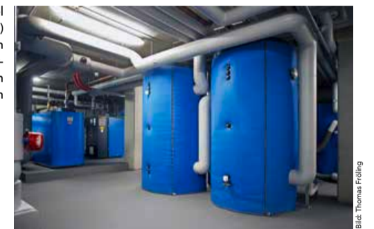
BHKW und Kessel (im Hintergrund) können Wärme in Systempufferspeichern zwischenlagern
