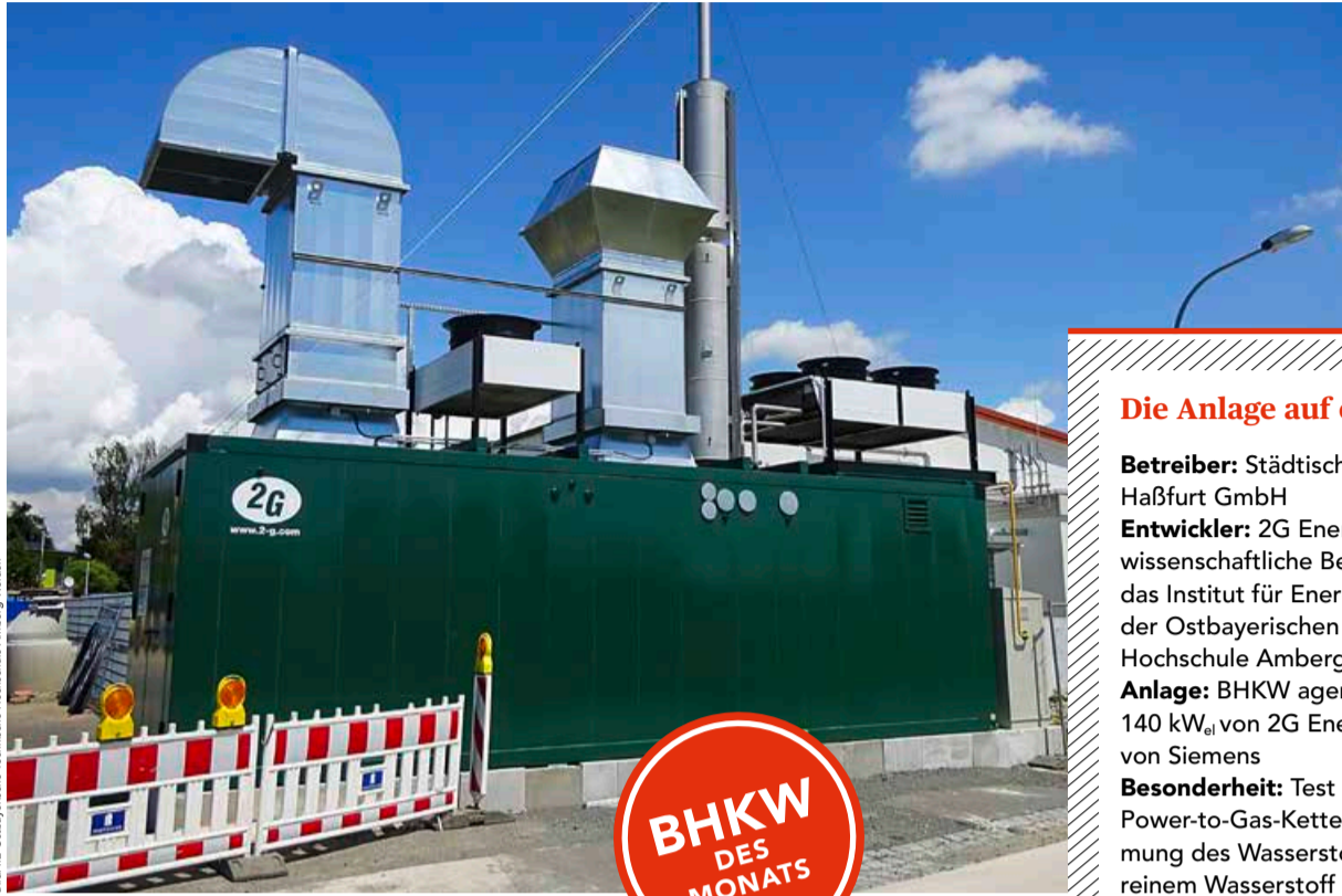
Das Wasserstoff-BHKW in Haßfurt wird umfangreich getestet
