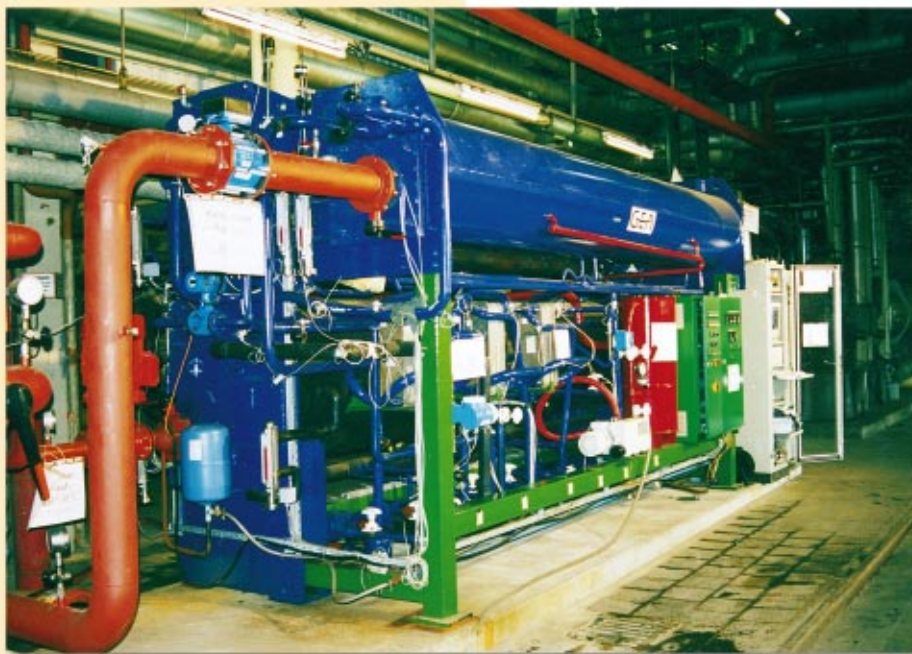
1 Single-Effect/Double-Lift Absorptionskältemaschine zur Kälteerzeugung aus Fern- und Nahwärme (Foto: GEA Happel)
