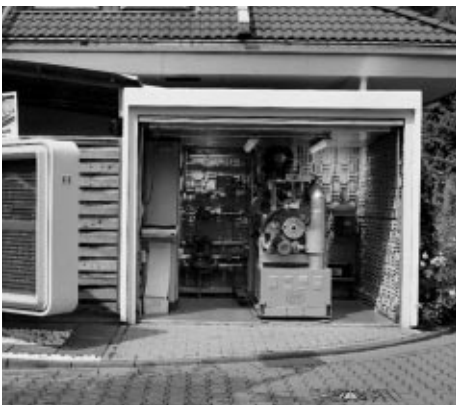
Abb. 5: Das 55 kW el -Modul findet Platz in der Garage des Lokals.
