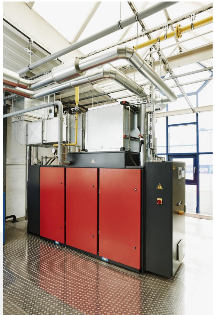
Bild: Druckluft-Wärme-Kraftwerk in der Energiezentrale der Bosch Thermotechnik GmbH in Lollar
