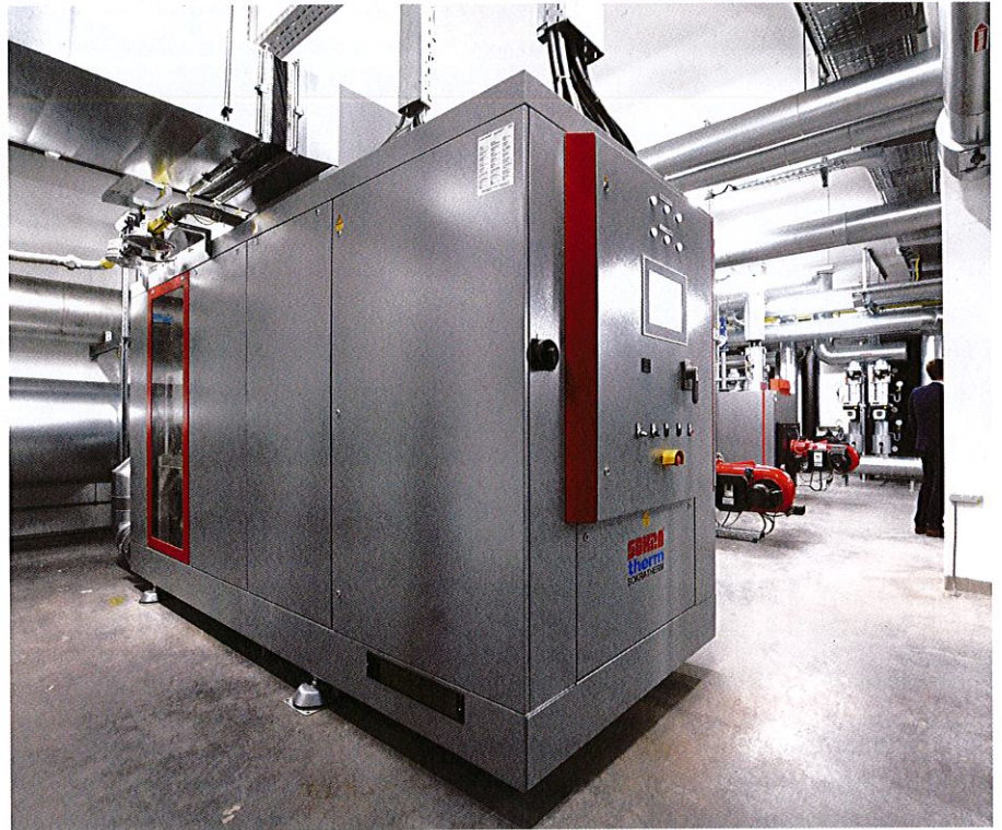
BHKW-Kompaktmodul GG 330 in der Energieverbundzentrale Waldbronn.
