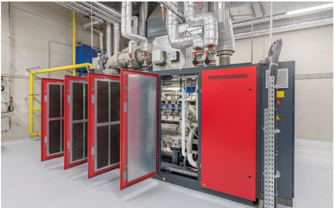
Das Bosch-BHKW beliefert den Standort mit 400 kW elektrischer und 500 kW thermischer Leistung – für Strom, Wärme und Kälte.
