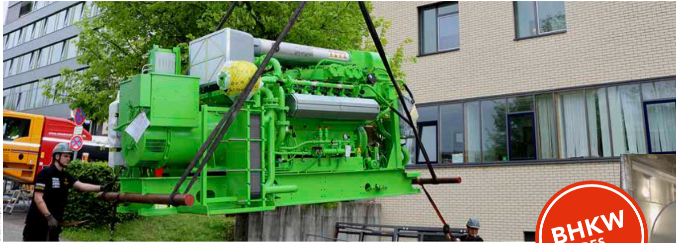
BHKW im Krankenhaus Bad Cannstatt: Für die BHKW-Nutzung ist ein gleichförmiger Energieverbrauch ideal
