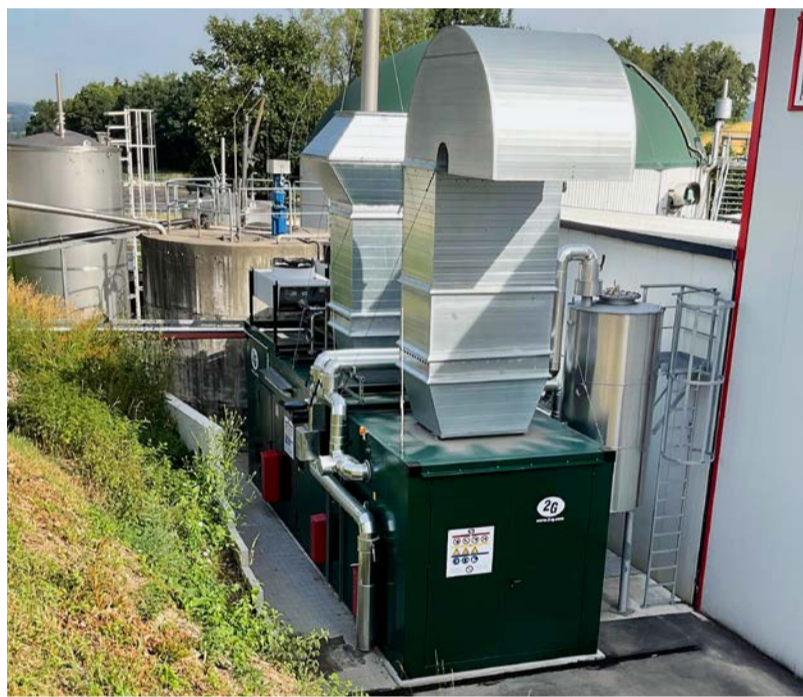
Das Blockheizkraftwerk bei Lorenz in Neunburg vorm Wald: Lorenz verwertet seine Abfall- und Reststoffe zu 100 Prozent. Dafür wurde neben der Biogasanlage auch ein BHKW errichtet
