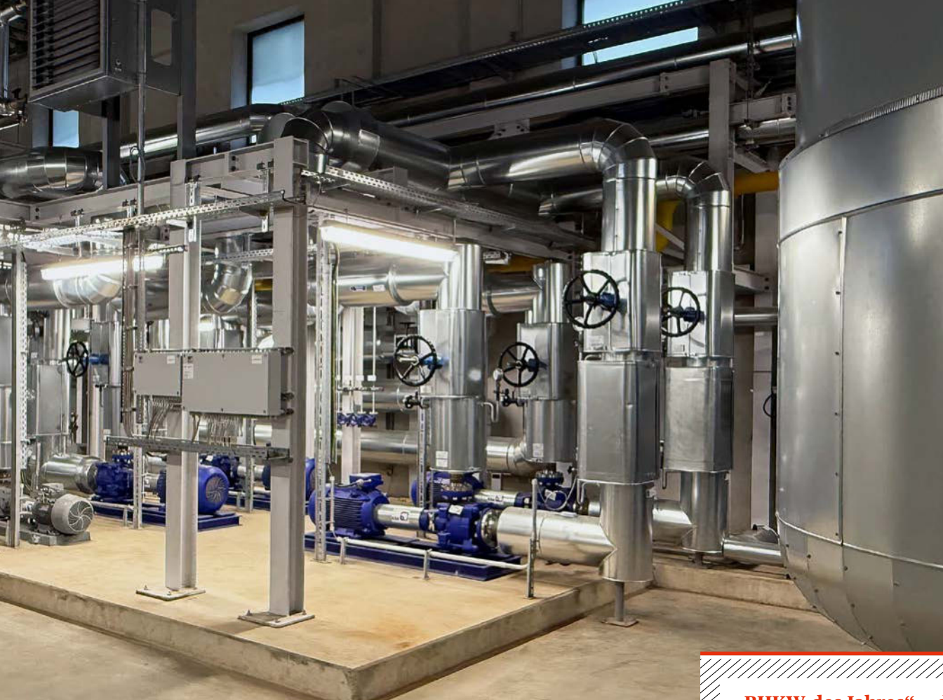
Die iKWK- Anlage Camphausen
