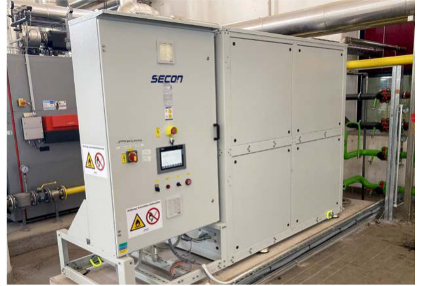
Die Wärmepumpe unterstützt in der Kläranlage Tübingen ein BHKW
